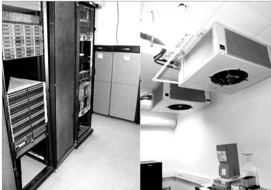
Новая серверная и ее охлаждение в заводууправлении
